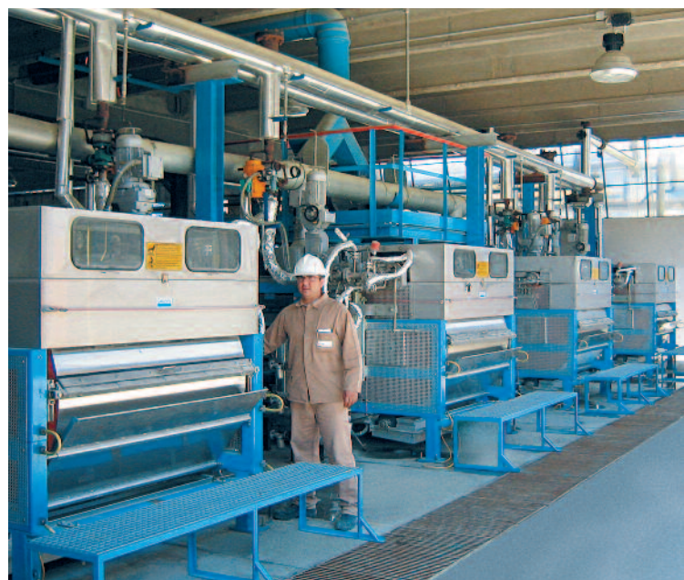
Установки Rotoform на заводе грануляции серы на Сицилии
