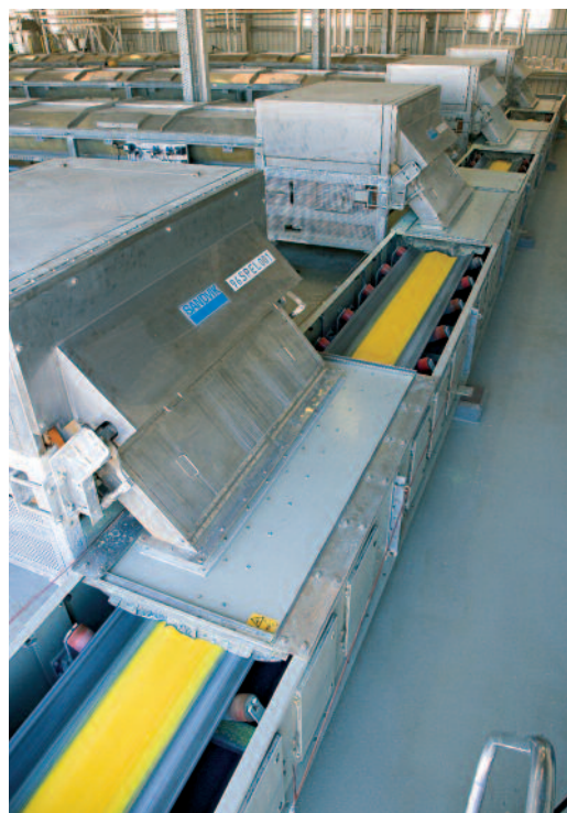
Разгрузочный узел конвейера-охладителя
